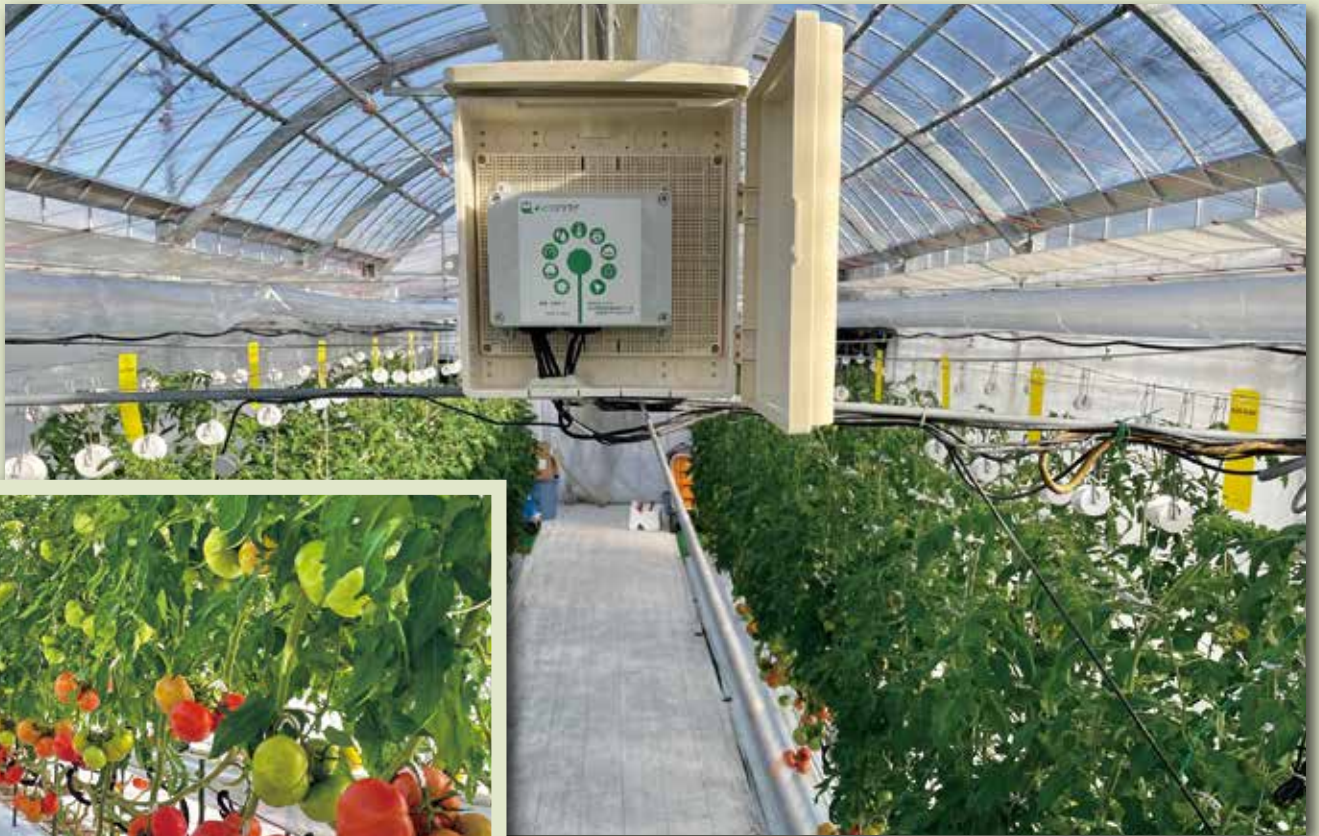
ハウス内に設置されている環境センサー
