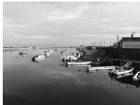
海岸堤防の老朽化対策が望まれる（楠漁港）
