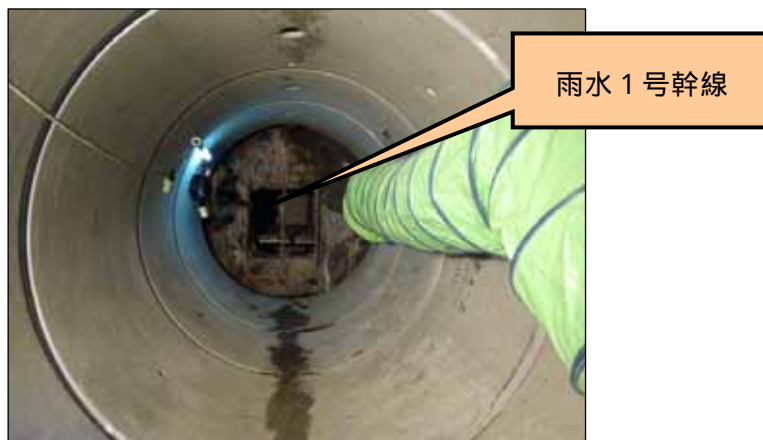
写真 5 : シールド外殻一部撤去状況 (撤去箇所に向こう側が雨水 1号幹線)
