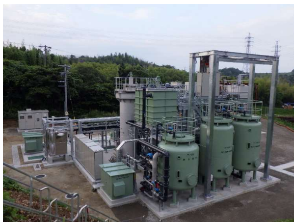
浸出水処理施設
