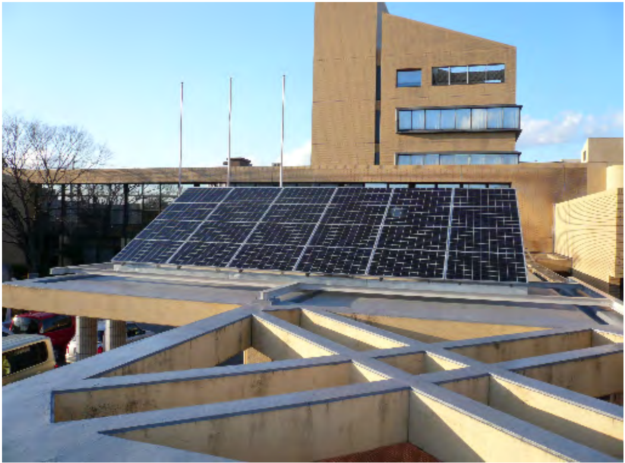
太陽光パネル
