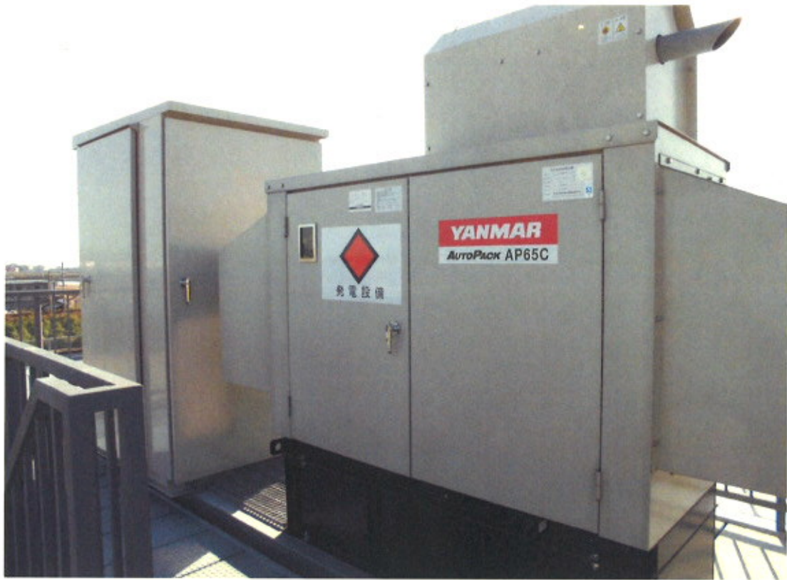
発電機・スコットランス盤②
