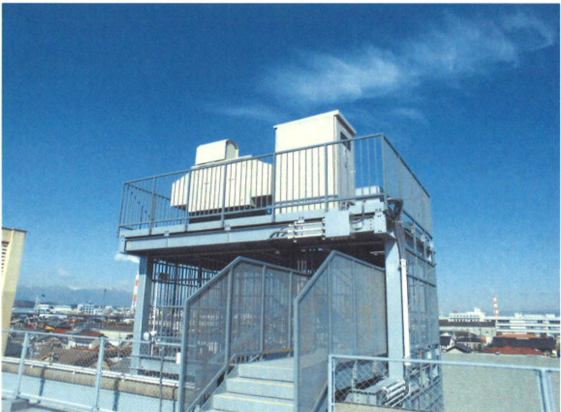
発電機・スコットランス盤
