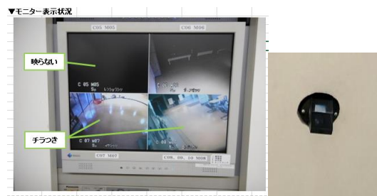
②防犯カメラ設備
