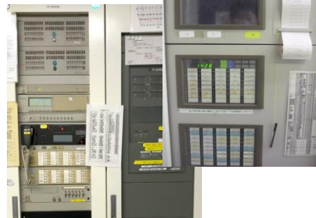
⑤中央監視装置
