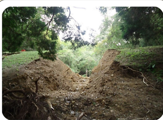
平成25年9月、大雨により決壊した他市町村のため池
