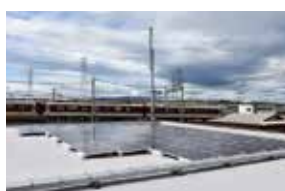
社屋に設置した太陽光パネル
