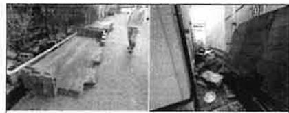
能登半島地震でも多くのブロック塀が倒壊した。
