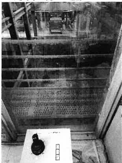
発電ボイラーの燃料となる鶏糞ピット
