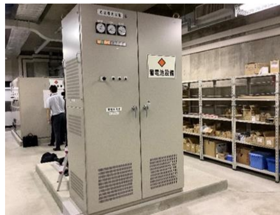
直流電源装置
