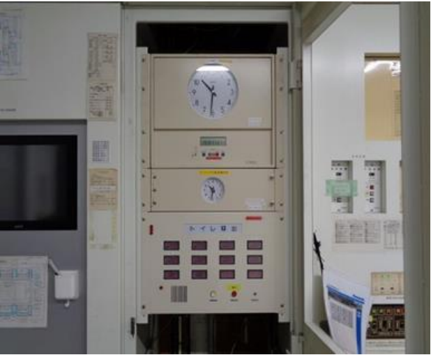
親時計・トイレ呼出し装置
