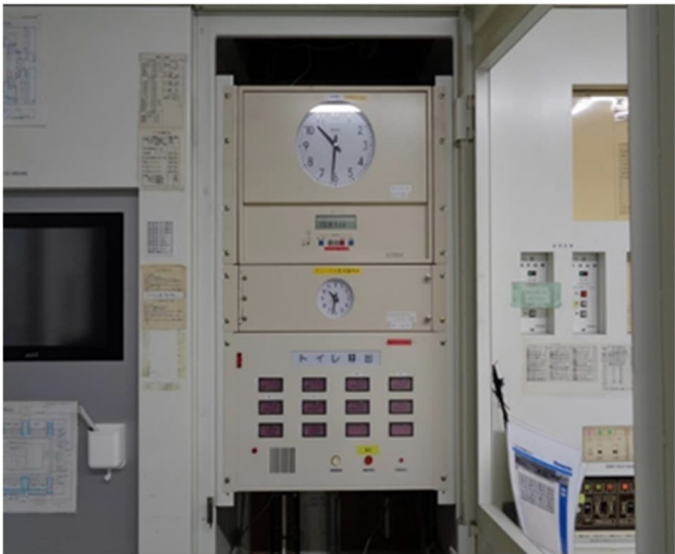
親時計・トイレ呼出し装置
