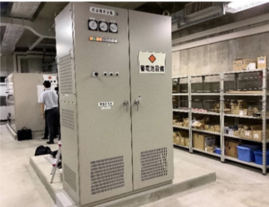
直流電源装置
