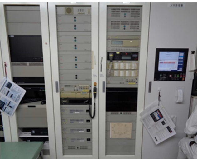
非常放送アンプ・自火報受信機
